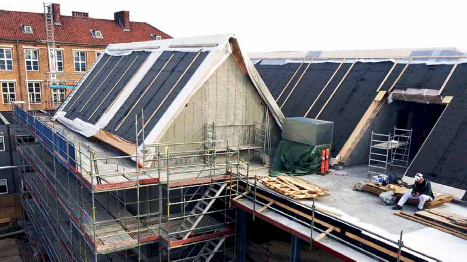
Skotrender mellem store saddeltage er kritiske med hensyn til fugt i bygninger – også i byggefasen. Her er vand trængt ind i tagkonstruktionen og i den underliggende etage under byggeprocessen, fordi en midlertidig skotrende kollapsede efter et regnskyl.
